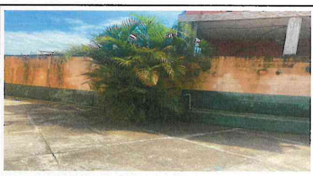
Foto 4: Pintura en mal estado
