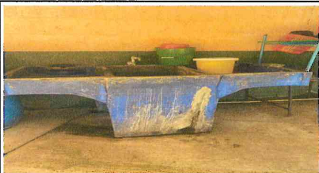
Foto 1: Pila en mal estado con filtraciones de agua
