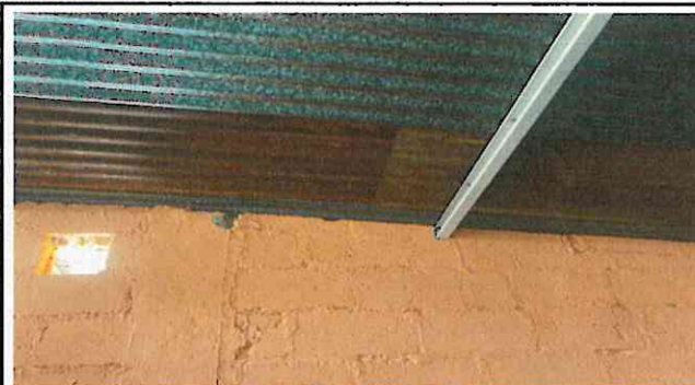
Foto 2: Lamina en mal estado
