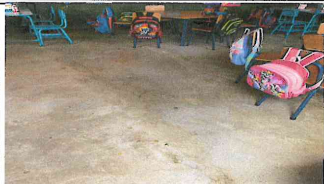
Foto 1: Aula que no cuenta con piso
