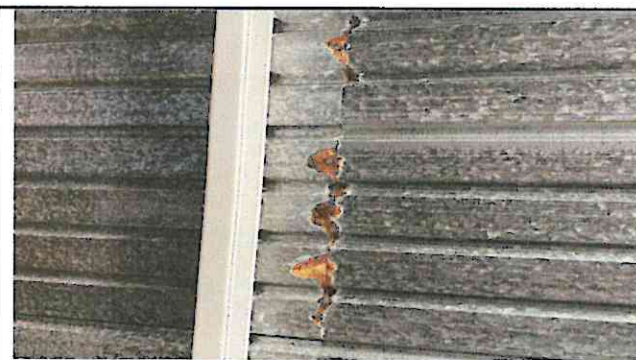
Foto 3: Lamina en mal estado
