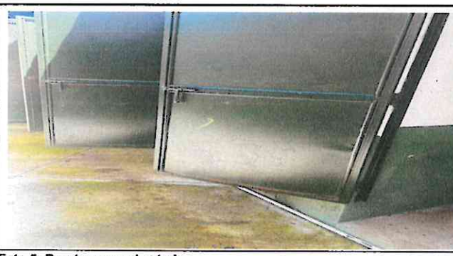
Foto 5: Puertas en mal estado
