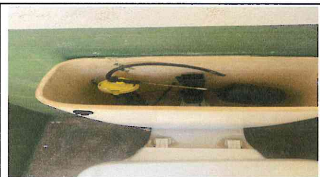
Foto 3: Accesorios de los depositos de agua quebrados.
